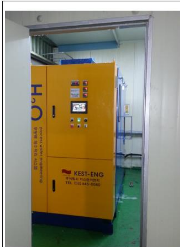
오리엔스 (경주) : 동양피스톤 자동차 부품 절삭 가공 헹장의 절삭유 폐수 -> 진공증발농축장치 -> 방류 일일 2톤 폐수처리
